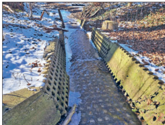
Ein mit Rasengittersteinen verbautes Gewässer. Die Platten sind instabil und im Hintergrund kann man sehen, wie sie bereits ins Gewässer fallen. Zurück bleibt ein ungeschütztes Ufer. Foto: Wetzelt, LfULG
